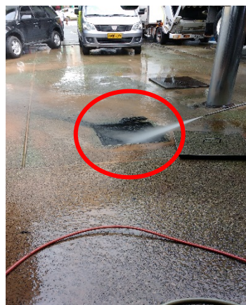
Foto No. 2 Evidencia de lodo y barro en la caja de inspección
